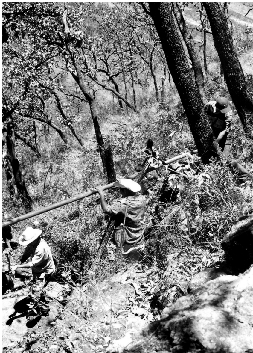
Imagen 9. Trabajo comunitario para el mantenimiento del sistema de distribución de agua
